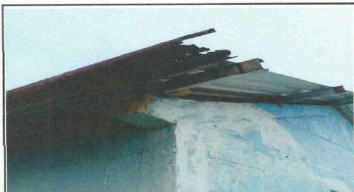
Foto 3: Sustrución de canales y bajadas de agua pluvial por deterioro.
