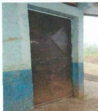
Foto 4: Sustrución de puerta de metal por deterioro de oxido.
